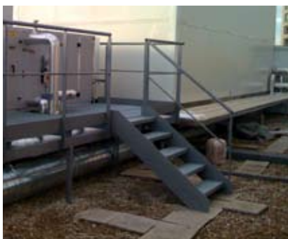
Plateforme technique pour CTA
